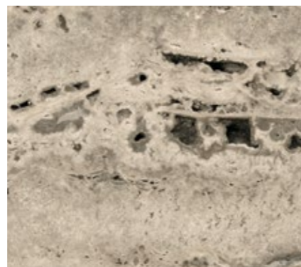
fori evidenti (dettaglio) clear holes (detail)
