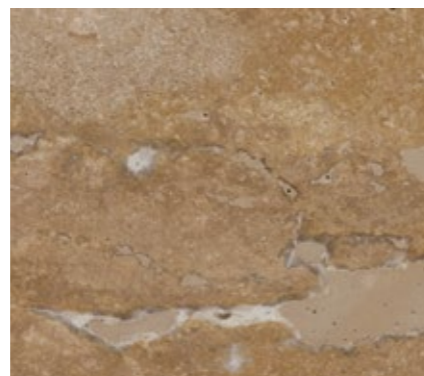
fori evidenti (dettaglio) clear holes (detail)
